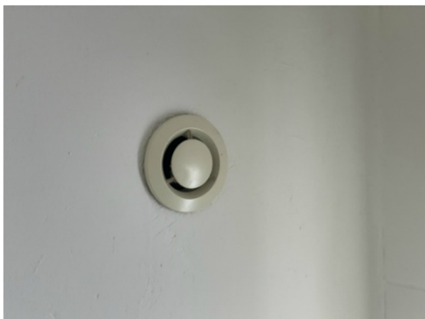
Vue sur l'une des bouches d'extraction d'air auto-réglable.
