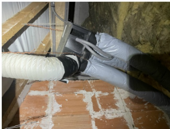
Vue sur la Ventilation Mécanique Contrôlée (VMC)
