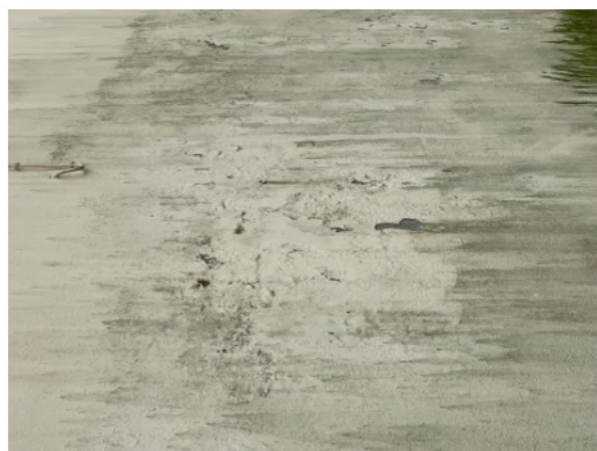
Moisissure et décollement peinture sur enduit.
