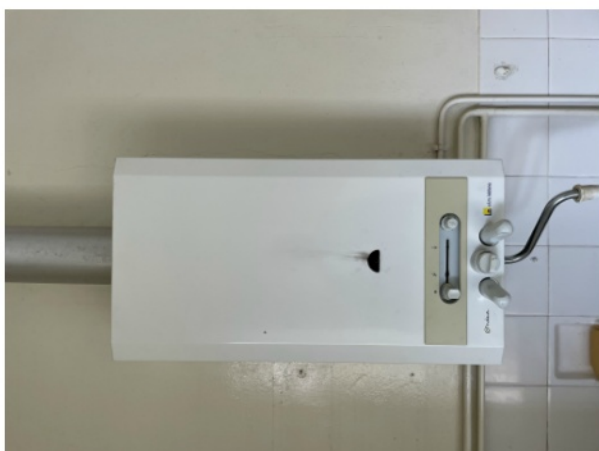
Chaudière gaz naturel murale à haute température (Eau chaude sanitaire)
