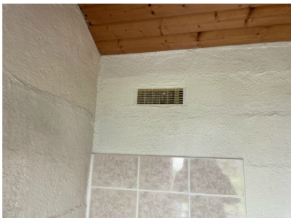
Grille d'entrée d'air = déperditions thermiques
